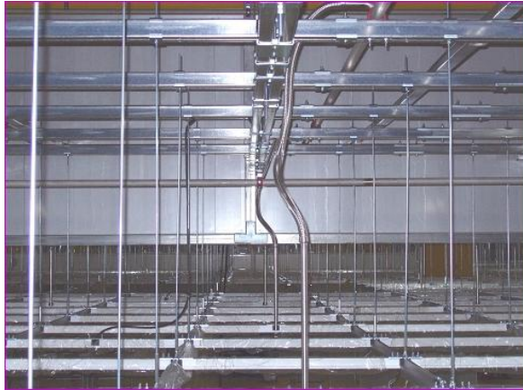
<그림 8> Clean Fab의 스프링클러 후렉시블 튜브의 설치 상태
