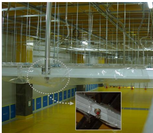
<그림 7> Clean Fab에 설치된 하향식 스프링클러헤드
