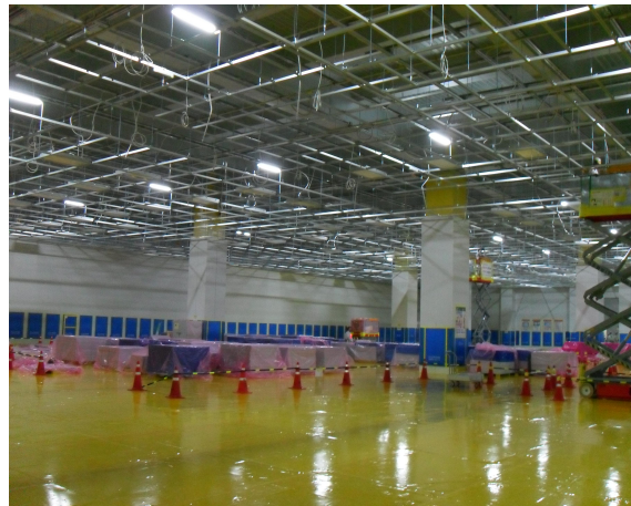
<그림 2> 클린룸 내 격자형 배관 설치 상태
