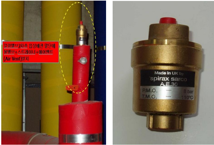
<그림 6> 자동에어벤트 설치 상태
