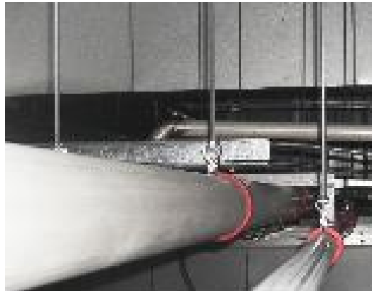
<그림 3> 클린룸 내 스테인레스 배관을 지지하는 절연행가 설치 상태
