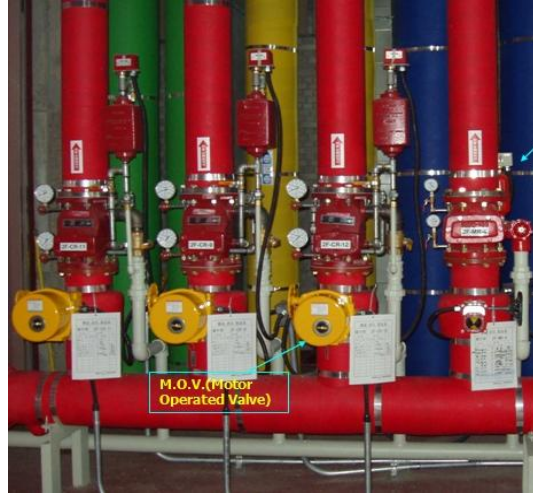
<그림 4> 습식유수검지장치 1차측 전동기 구동밸브 설치 상태
