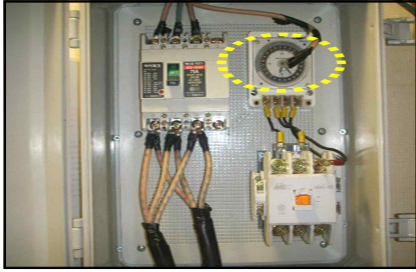
<그림 7> 전기분전반 안에 설치된 타이머 장치
