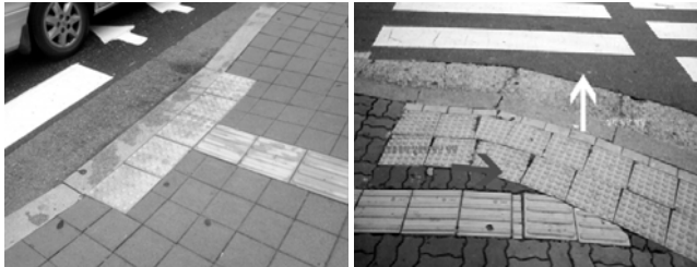
a) 경고블록 설치폭, 설치위치의 오류
