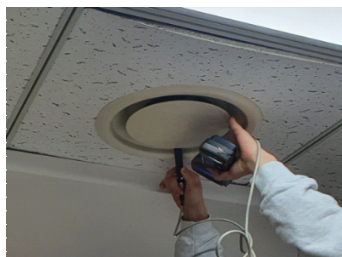
(b) 급·배기구 풍속 측정 (열선풍속계)
