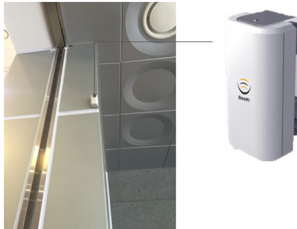
〈그림 4〉 도서관 출입구에 설치된 비콘 사진
