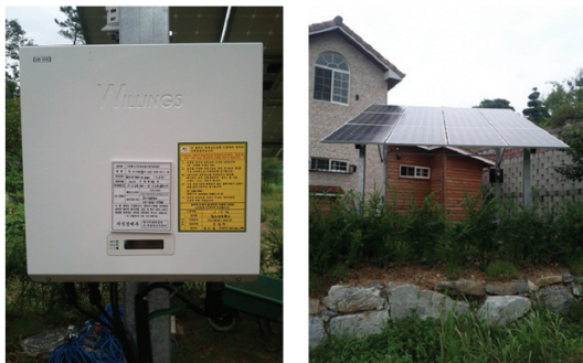
그림 13. 태양광 발전설비 및 인버터 Figure 13. Solar installations and inverters
