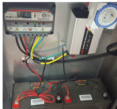
그림 4. 태양광 전력 조정 합체 Figure 4. Metal Box to Control Solar Power System
