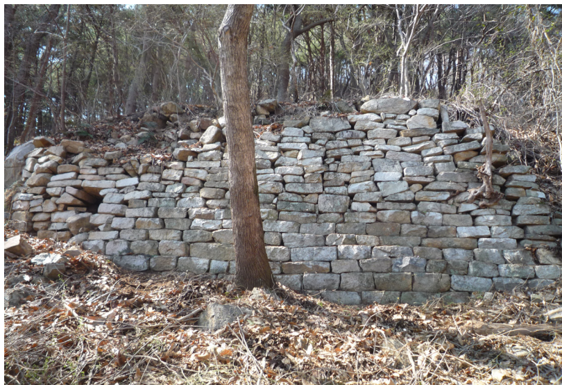
도 9. 신기리산성 동벽 체성부 외벽 잔존 상태 근경
